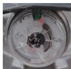
× 指示圧力計の損傷
