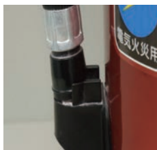
× 消火薬剤の漏れ
